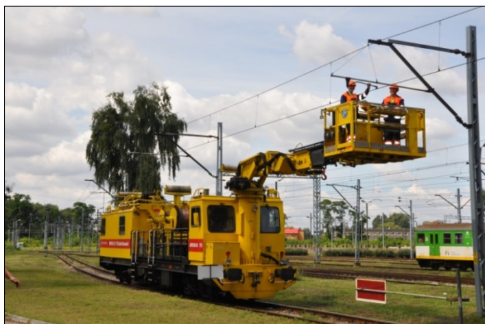
(Zdjęcie pozyskano w ramach kontroli NIK)
